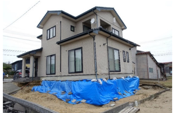
写真 1-2 建物の周辺地盤が沈下して改良体の頭部が露出した例 1)
