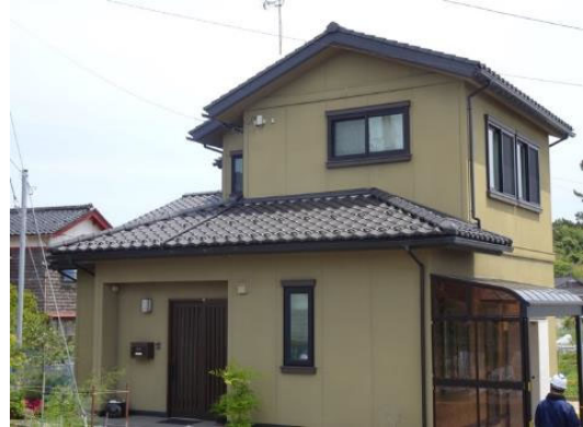
写真 5-2 令和 5 年 5 月の地震後の状況 3)
