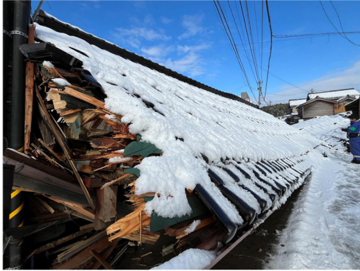
写真 5-6 倒壊した建築物の瓦屋根
