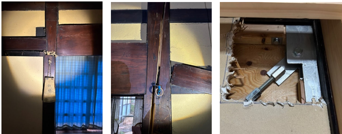
写真 2-4-1 一般的な破壊事例とは異なる柱の折損と補強金物
