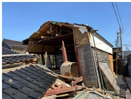
写真 4-1-4 部分二階建ての倒壊事例
