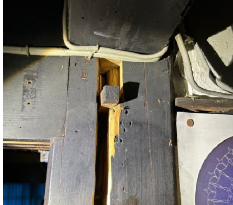
写真 2-3-3 込栓からの割裂破壊
