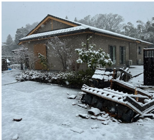
写真 5-5 住宅に隣接した門の倒壊
