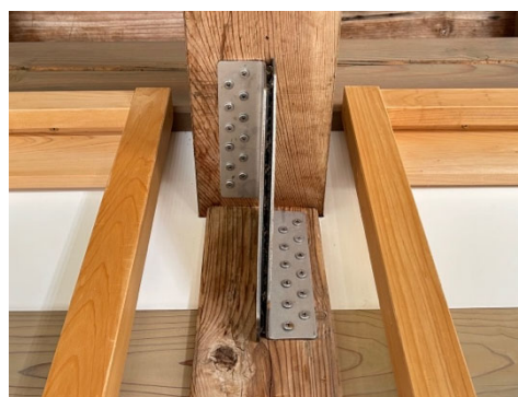
写真 3-2 仕口補強金物の粘弾性体の部分の損傷
