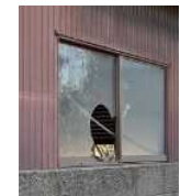
窓が割れた 管理不全空家
