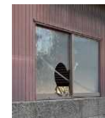
窓が割れた 管理不全空家
