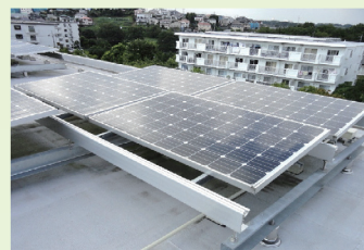
太陽光発電関連設備の設置
