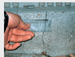
基礎のひび割れ
