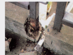
手すりの支持部の腐食
