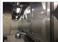
耐震性貯水槽
