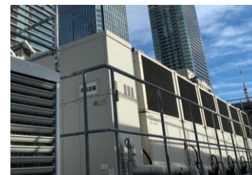
屋上の省エネ設備
