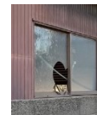
窓が割れた 管理不全空家
