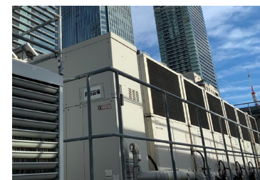
屋上の省エネ設備
