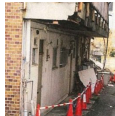
外壁剥落等の危険な状態
