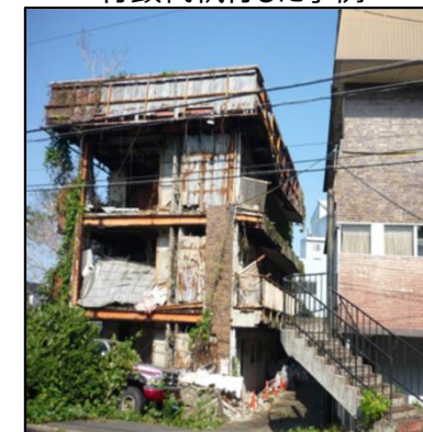
保安上危険な状態として行政代執行した事例
