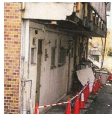
外壁剥落等の危険な状態
