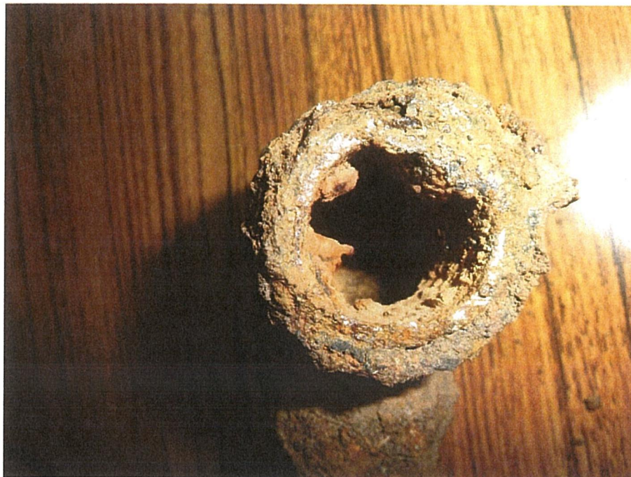
給水管エルボ錆
