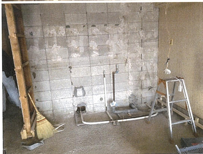
キッチン廻り配管状況
