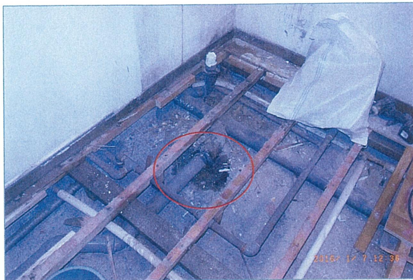
洗面所 配管 漏水 (607 号室)
