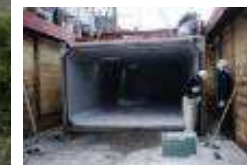
防火水槽（うきは市筑後吉井）
