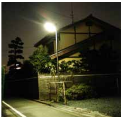
【補助を受けて設置された独立式防犯灯】
