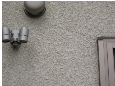
写真1: 外壁ひび割れ
