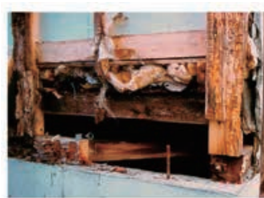
写真 3.2.3 内部結露による躯体の腐朽
