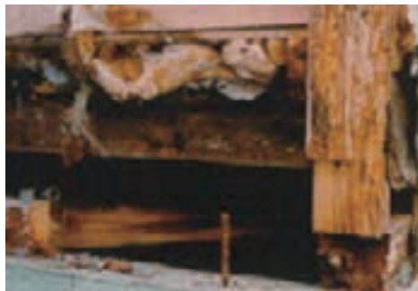
写真 4.1.3 結露による腐朽
