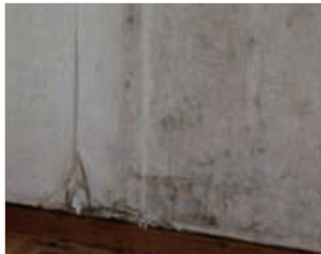
写真 4.1.2 カビによる汚損
