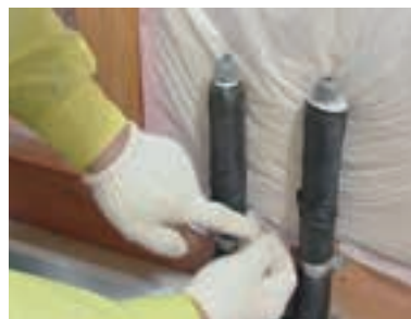
写真 5.1.1 配管まわりの防湿フィルム
