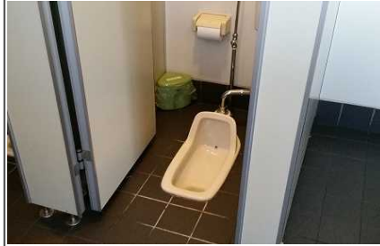
【改修する設備等写真】(改修の場合は必須)
