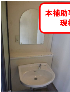
【改修する設備等写真】(改修対象がある場合は必須)
