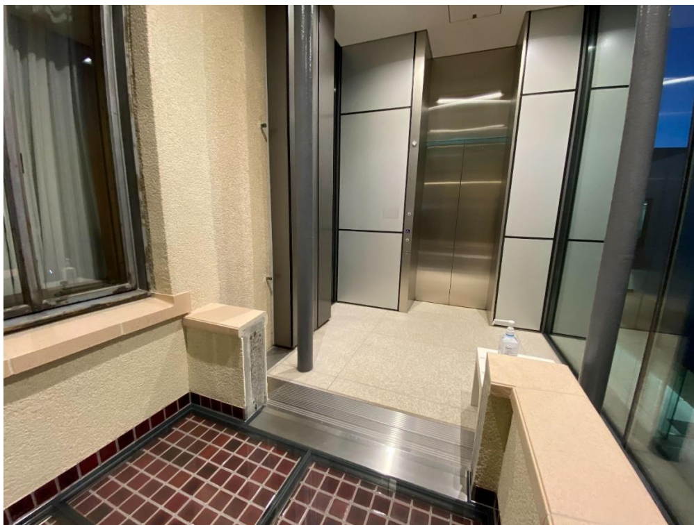
本館バルコニーに整備したエレベーター (バルコニーの改変部分が分かるように整備)
