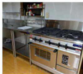
セントラルキッチン改修
