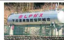
温泉街全体にガス管を配置しガス供給を行う「コミュニティーガス事業」
