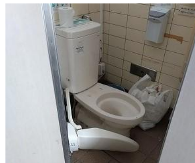
便座が壊され、ごみが溢れる トイレ
