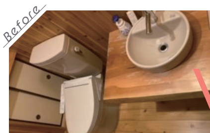
手すりやオストメイト対応設備がなく、身体の状態によっては利用に不安が残る空間だった。
