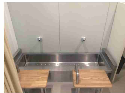
座って利用できる洗浄設備を2口設置
