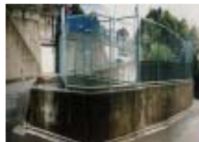
従前の防災調整池 (約500m 3 規模)
