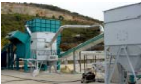
粉塵回収（集塵機）
