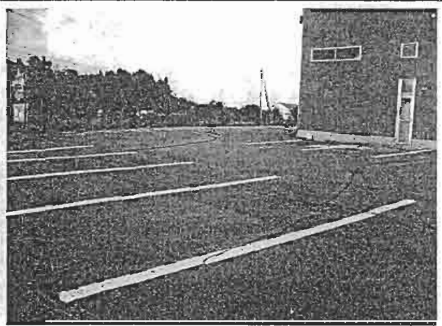
公園側ののり面天端にテンションクラックが円形に発生し、クラック深さは1.7m程度あった。
