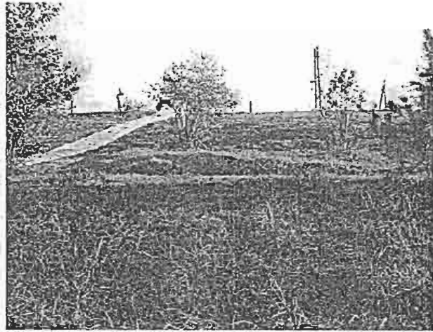
公園側ののり面が中腹で滑り出している。
