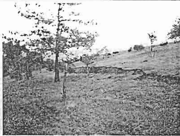
公園側ののり面が下部にテンションクラックが発生し、1m程度の段差がある。
