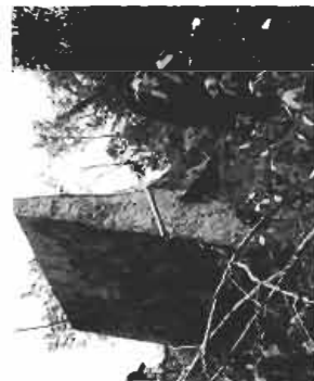
写真7.23 高町団地の被害状況
