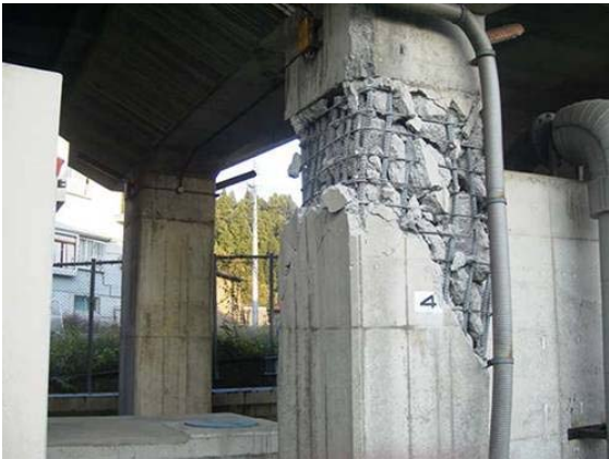
第三和南津高架橋の損傷状況
