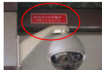
「監視カメラ作動中」などの警戒メッセージを目立つように表示 (上: JR東日本、下: 遠州鉄道)
