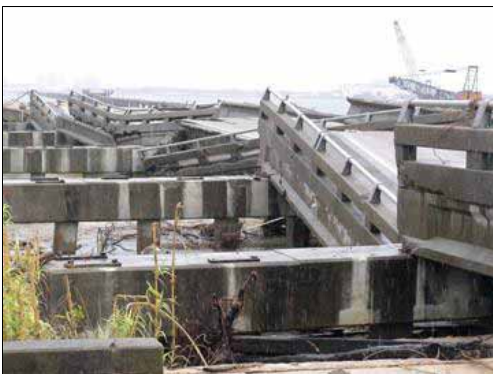
写真 3 オーシャンスプリングス側の橋の被害（上陸地点より約 80 km 東） 橋桁が陸側に移動し落ちている。 落橋は水位の上昇によって波による衝撃的な揚圧力の作用によると考えられる。
