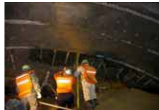
天端崩落状況
