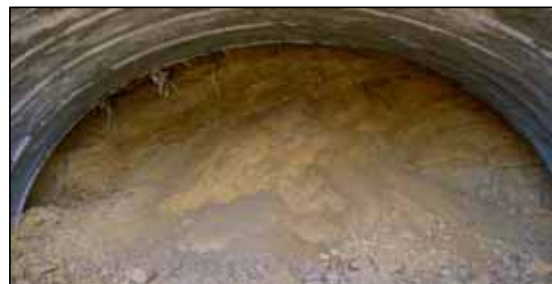
切羽崩落状況
