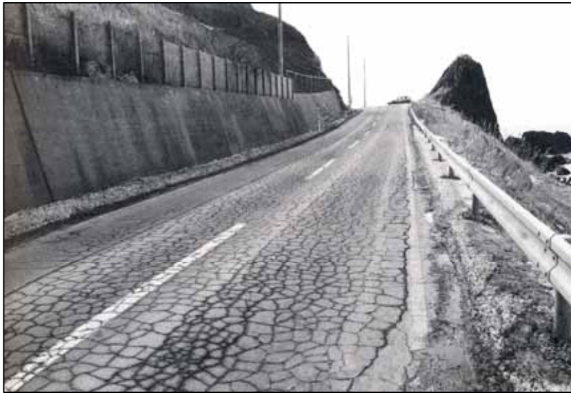
舗装面の亀甲状クラック
