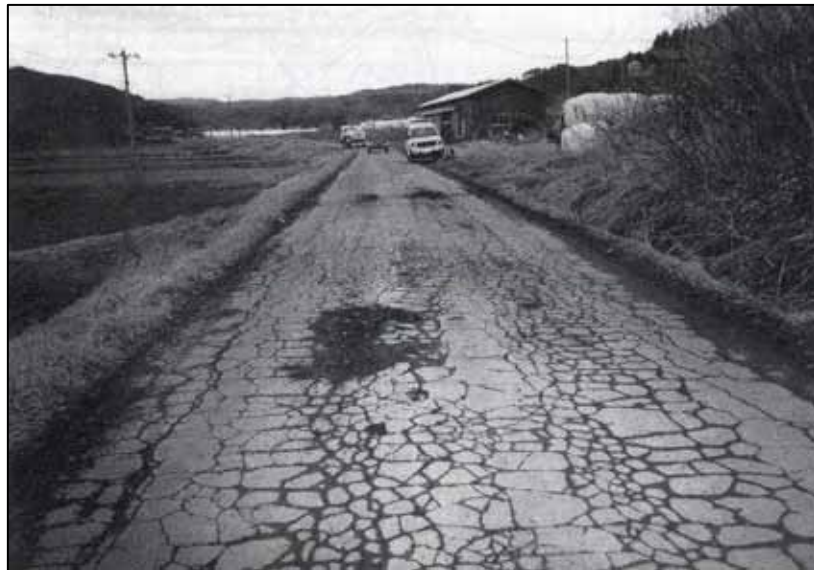
舗装剥離による穴
