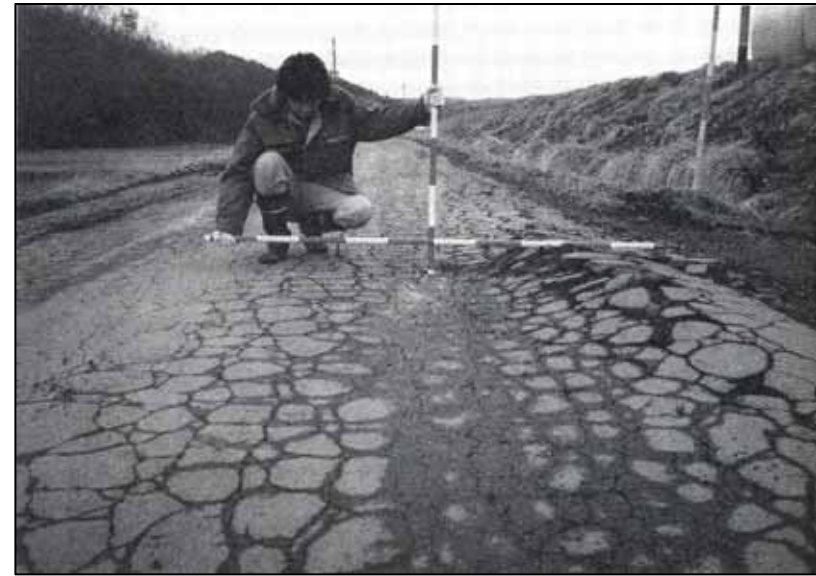
舗装面の盛り上がり、沈下
