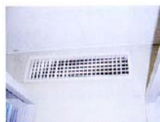
図5 壁面・天井面吹出口
