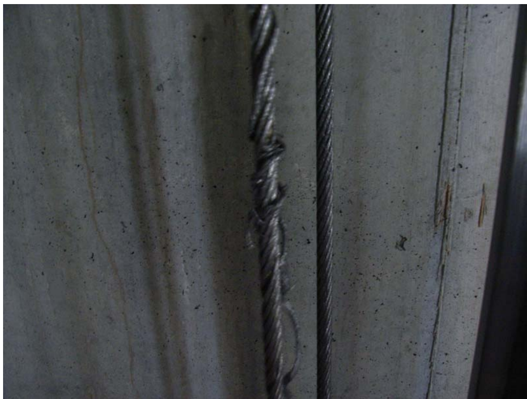
プロムナード菰窪ロープ一部破断状況
