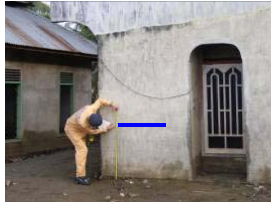
写真－7 浸水痕跡
