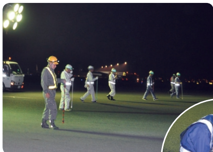
打音点検の様子。ひび割れは注入材で補修。軽度なものはこのまま経過観察するが、緊急性の高いものはすぐに工事を行う。
