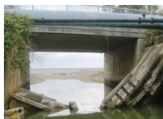
つは おおぎみそん 落下した津波橋 (沖縄県大宜味村)
