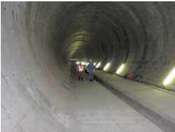
新羽末広幹線 管内写真(直径が8.5mの大幹線です)
