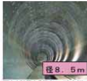
雨水を貯留する管きよ (東京都)
