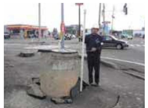
新潟県中越地震におけるマンホールの浮き上がり (新潟県小千谷市)
