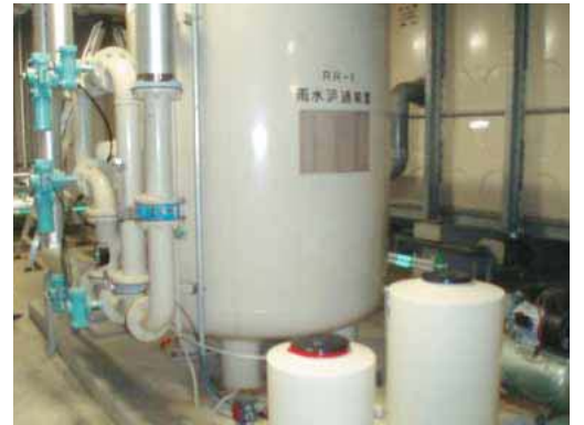
雨水濾過装置
