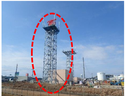
福岡空港 ASRアンテナ
