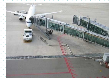
電力供給の様子
