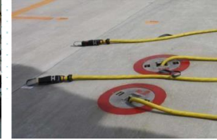
電力用ピット
