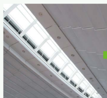
日差しが少ない早朝や夕方は、外光に合わせて照明を一部消灯。日差しが多い日中は、ほぼ全て消灯。
