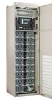
蓄電池設備 (キュービクル式の設置例)
