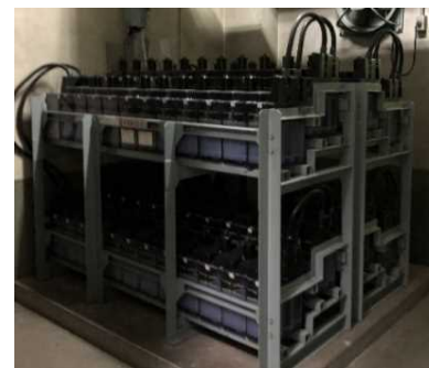
蓄電池設備 (開放式の設置例)
