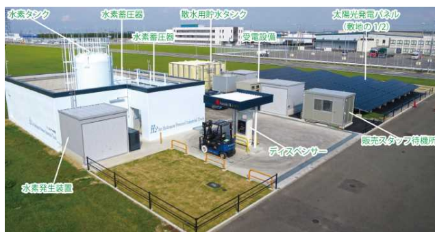
写真 5.2.3 中部国際空港 貨物地区水素充填所 (オンサイト方式)
