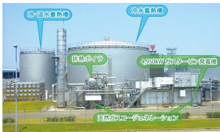
図 3.3.35 コージェネシステムの外観 (中部国際空港)
