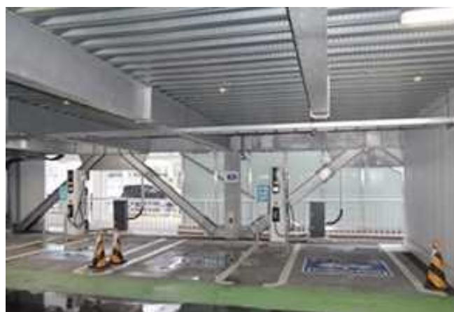
写真 5.2.2 福岡空港 お客様駐車場 (急速充電装置)
