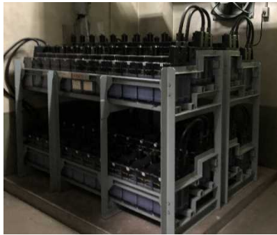
写真 5.3.3 蓄電池設備 (開放式の設置例)
