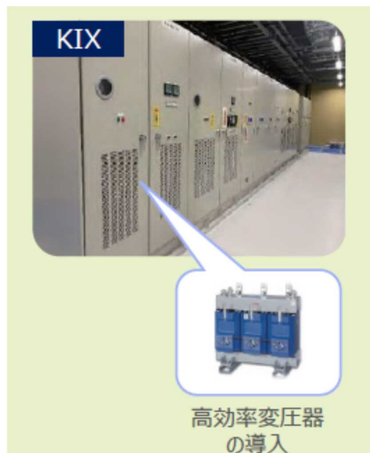
図 1.9 高効率変圧器
