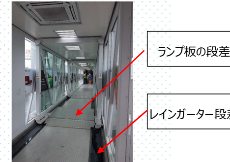
既存PBBトンネル内の段差
