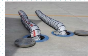
エアコン用ピット
