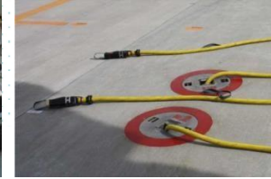
電力用ピット
