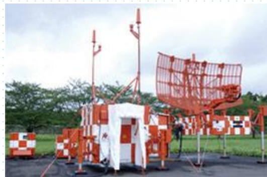
レーダー装置外観
