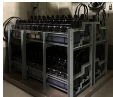
蓄電池設備 (開放式の設置例)
