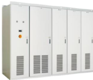
写真 5.3.2 キュービクル式 リチウムイオン蓄電池
