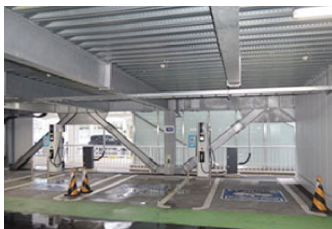
写真 5.2.2 福岡空港 お客様駐車場 (急速充電装置)
