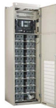
写真 5.3.4 蓄電池設備 (キュービクル式の設置例)
