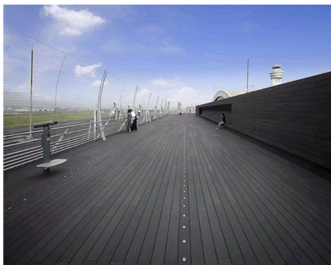
図 4.1.5 木材・プラスチック再生複合材(WPRC)のデッキでの施工例
