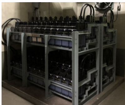
写真 5.3.3 蓄電池設備 (開放式の設置例)
