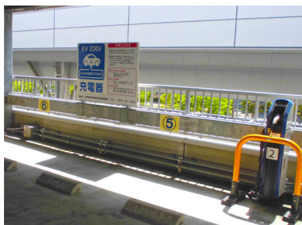
写真 5.2.1 中部国際空港 お客様駐車場 (普通充電装置)
