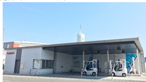
写真 5.2.6 産業車両用水素ステーション
