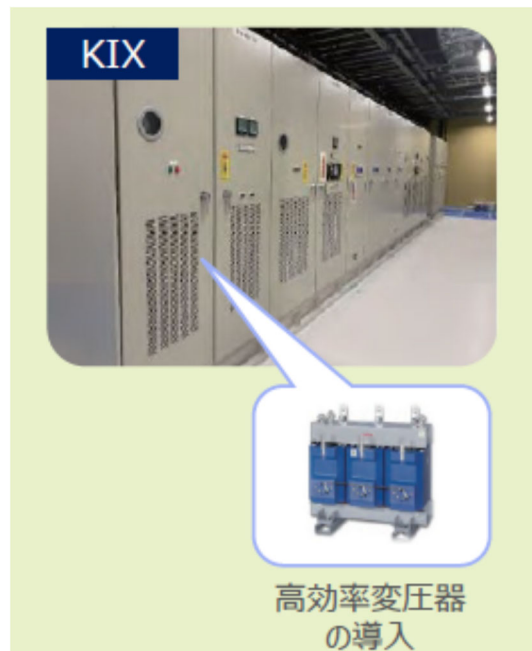
図 5.9 高効率変圧器
