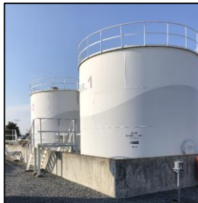
②貯油タンク
