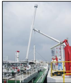
タンカーと桟橋上配管 を接続する装置
