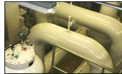
主配管と枝管の分岐・交 流点に設置した地下ピット
