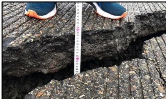
滑走路のひび割れ
