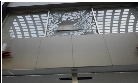
ターミナルビル内ガラス破損
