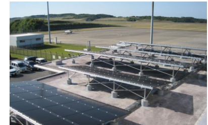
屋根置型の太陽光発電設備
