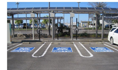
EV充電設備
