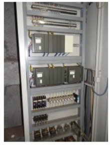
空調制御用コントローラー
