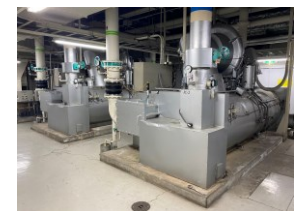
既存熱源設備
