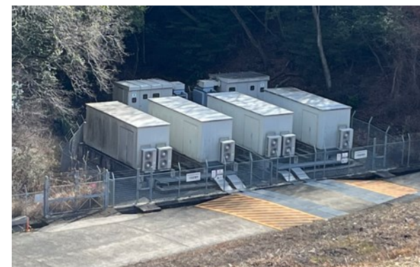
パワーコンディショナーの設置状況
